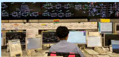
運行管理等のシステム改修
